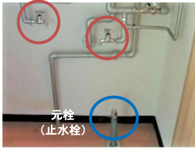
①②元栓(止水栓)、各水抜蛇口
