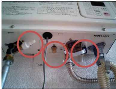
⑧給湯器下部
